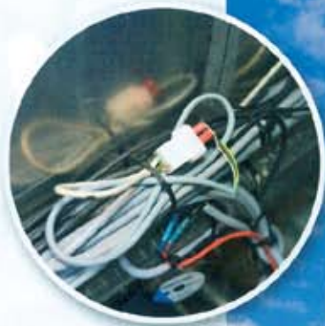
▲ De bedrading is plaatselijk slordig aangelegd.
